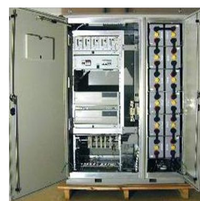
ARMÁRIOS E SISTEMAS RETIFICADORES PARA TELECOMUNICAÇÕES (2000)
