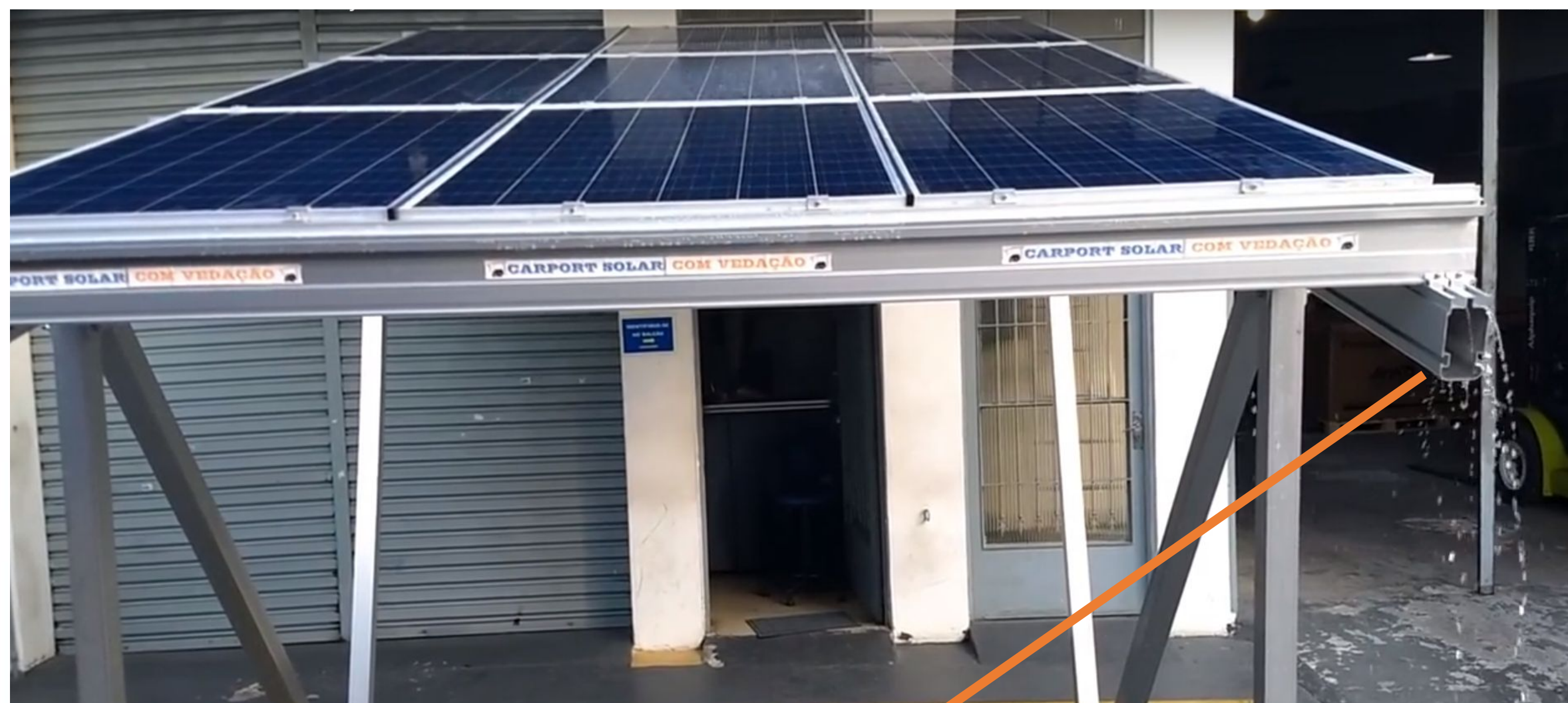
Sistema de escoamento de água
